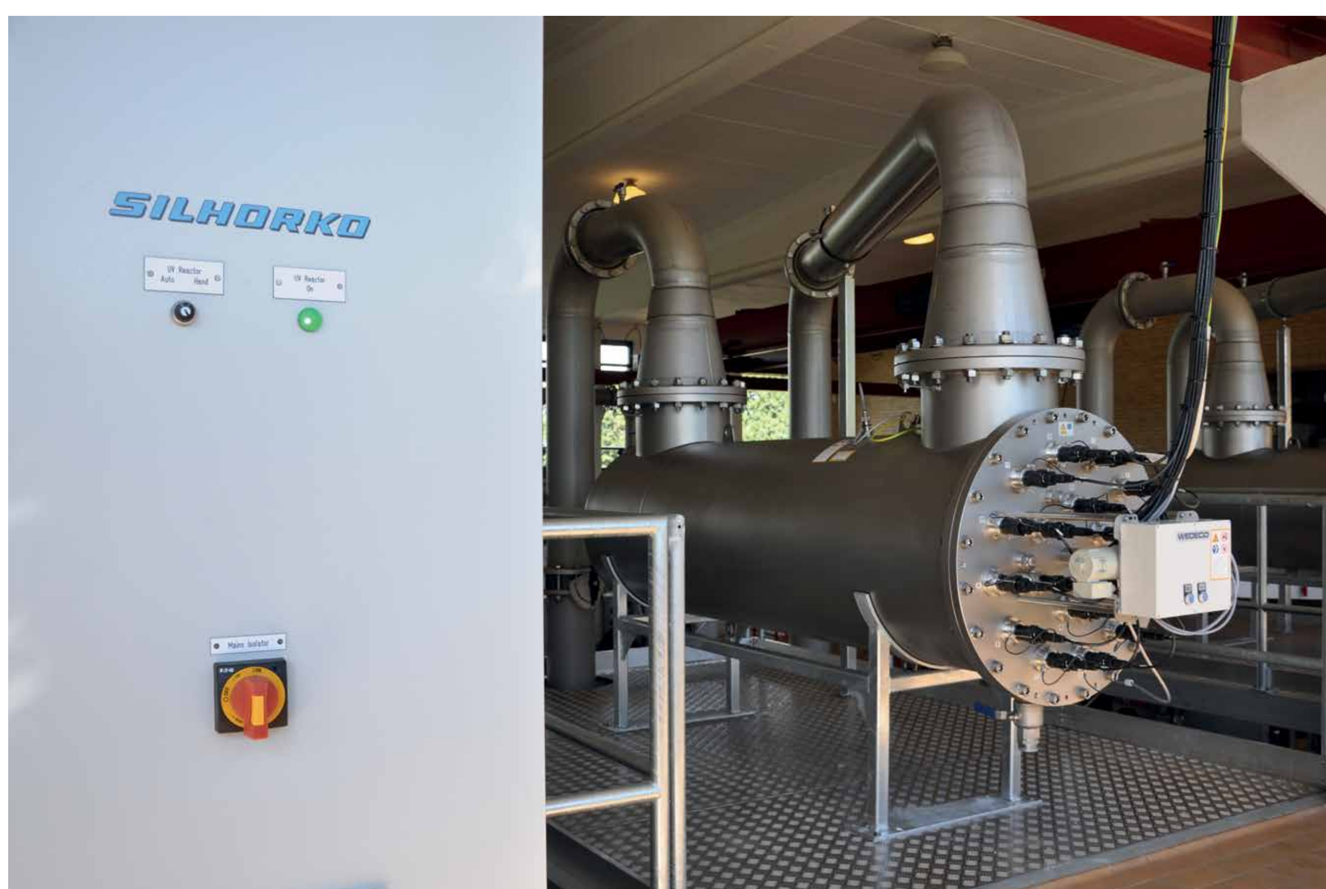
UV-anlægget belyser vandet for at dræbe eventuelle bakterier og vira.
