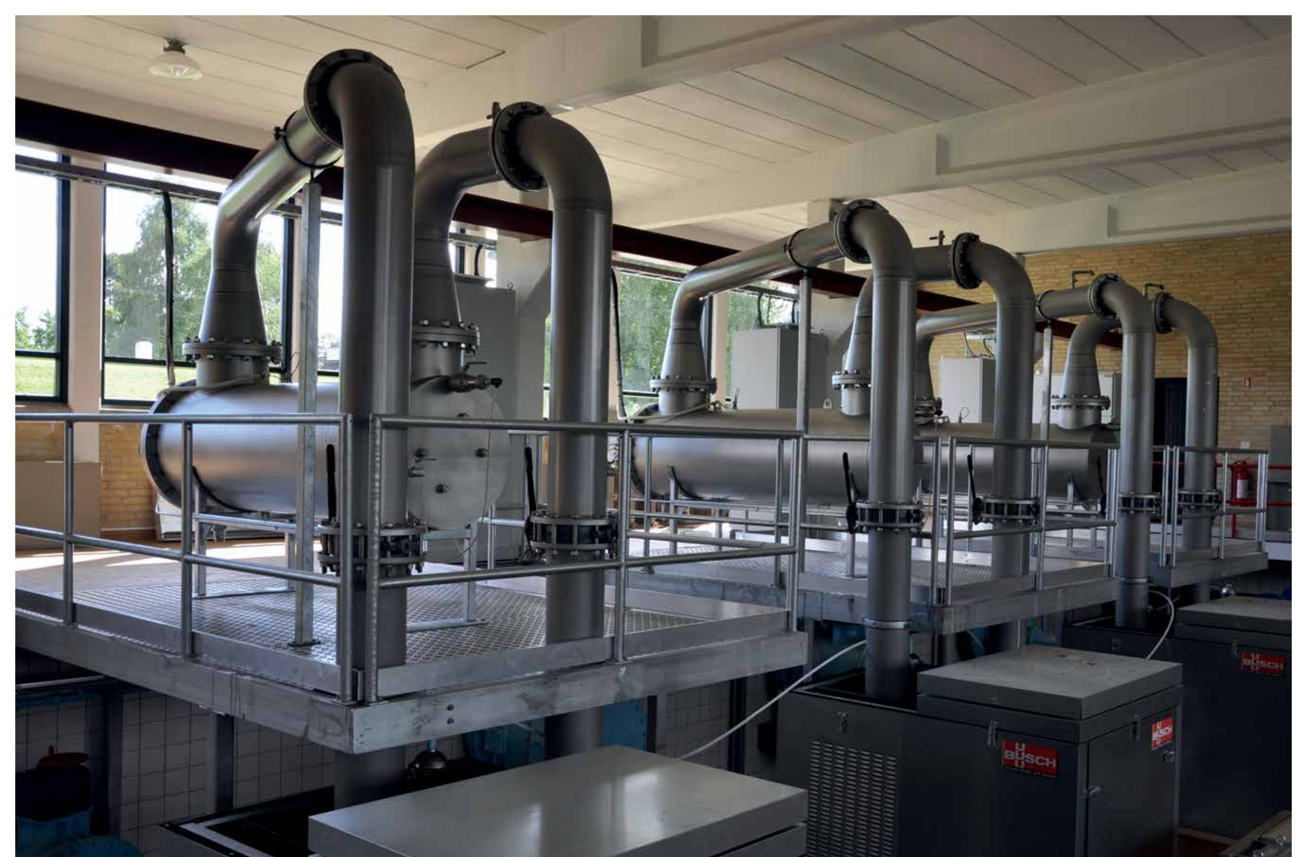
Der er 5 UV-anlæg på Sjælsø Vandværk, der alle kan belyse 500 m 2 vand i timen.
